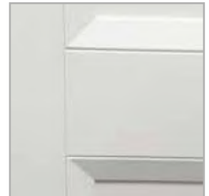
faza na łączeniu ramiaków
